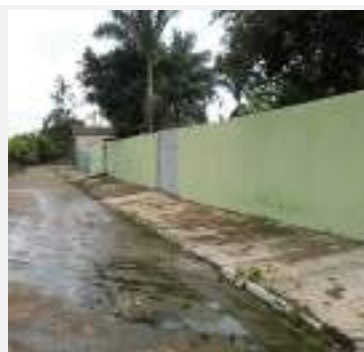
Detalhe do muro do imóvel avaliando (Residencial) matrícula nº 10.351, Lote 15, Quadra 108, Rua Niterói, Setor Norte, município de Cristalina-GO.
