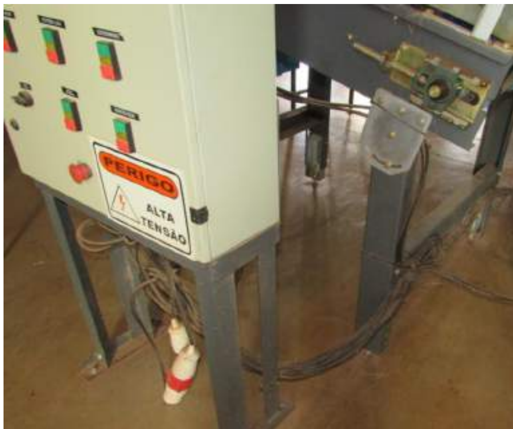
Figura 10 – Quadro de comando elétrico.
