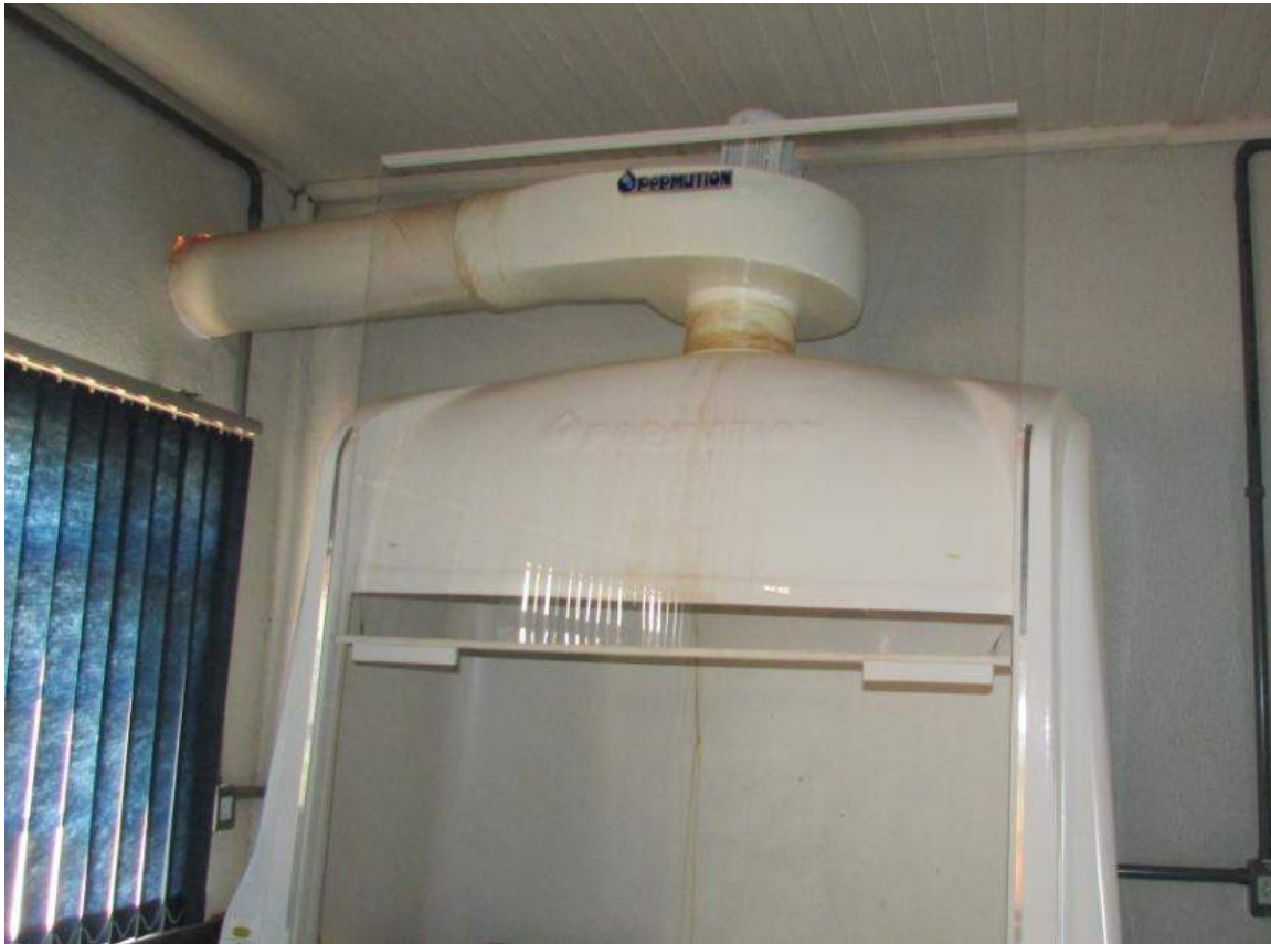
Figura 12 – Capela de PVC e galeria exaustora.
