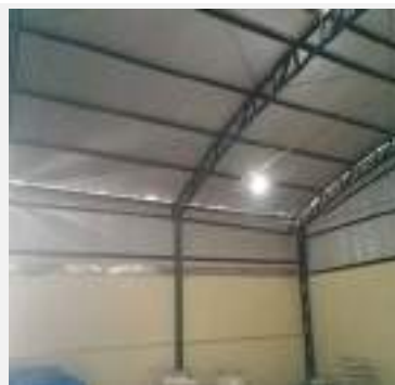
Detalhe do interior do Imóvel avaliando - Galpão Comercial da empresa Brava Agronegócios LTDA, matrícula nº 8.716, Lote 09, Quadra 108, Setor Norte, município de Cristalina-GO.
