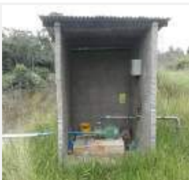
Detalhe da casa de bomba na represa de captação de água, nos fundos do imóvel avaliando, (Matrícula nº 25.572 - Faz. Realeza), (Coordenadas: 16°45'38.30"S | 47°33'7.05"O), município de Cristalina-GO.
