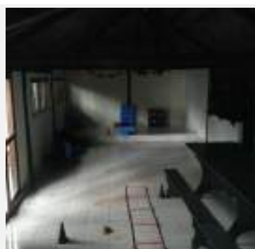
Detalhe do interior do Imóvel avaliando (Salão - Primeira construção, c/ 101,63m 2 ) matrícula nº 10.351, Lote 15, Quadra 108, Rua Niterói, Setor Norte, município de Cristalina-GO.
