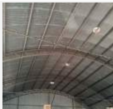
Detalhe da estrutura de cobertura do Galpão p/ depósito de produtos, Brava Agronegócios, município de Cristalina-GO.
